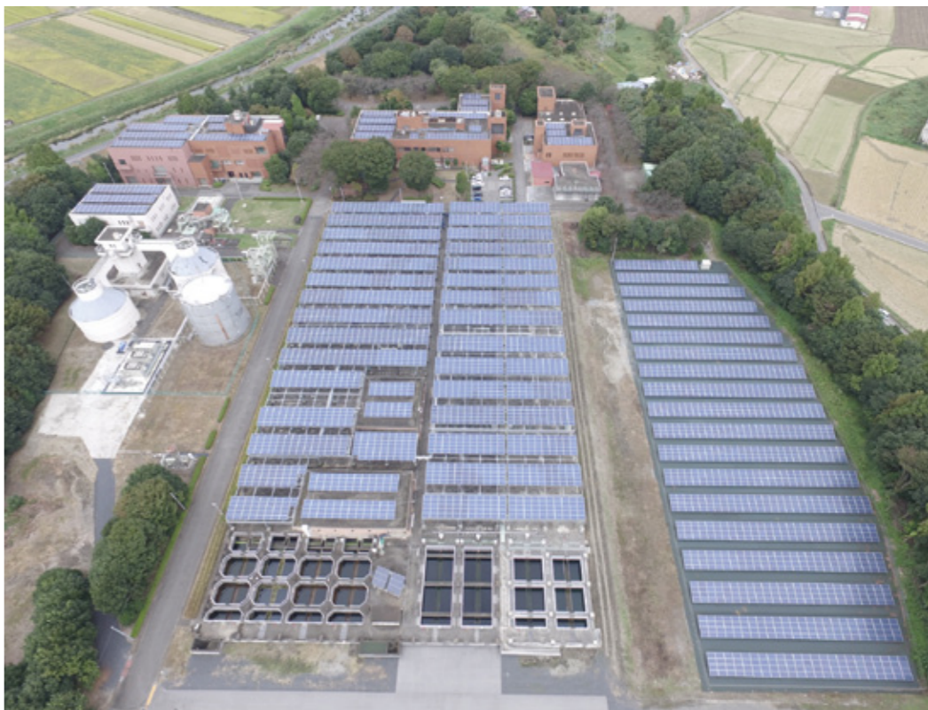
巴波川浄化センターに設置された太陽光発電システム(栃木市)
