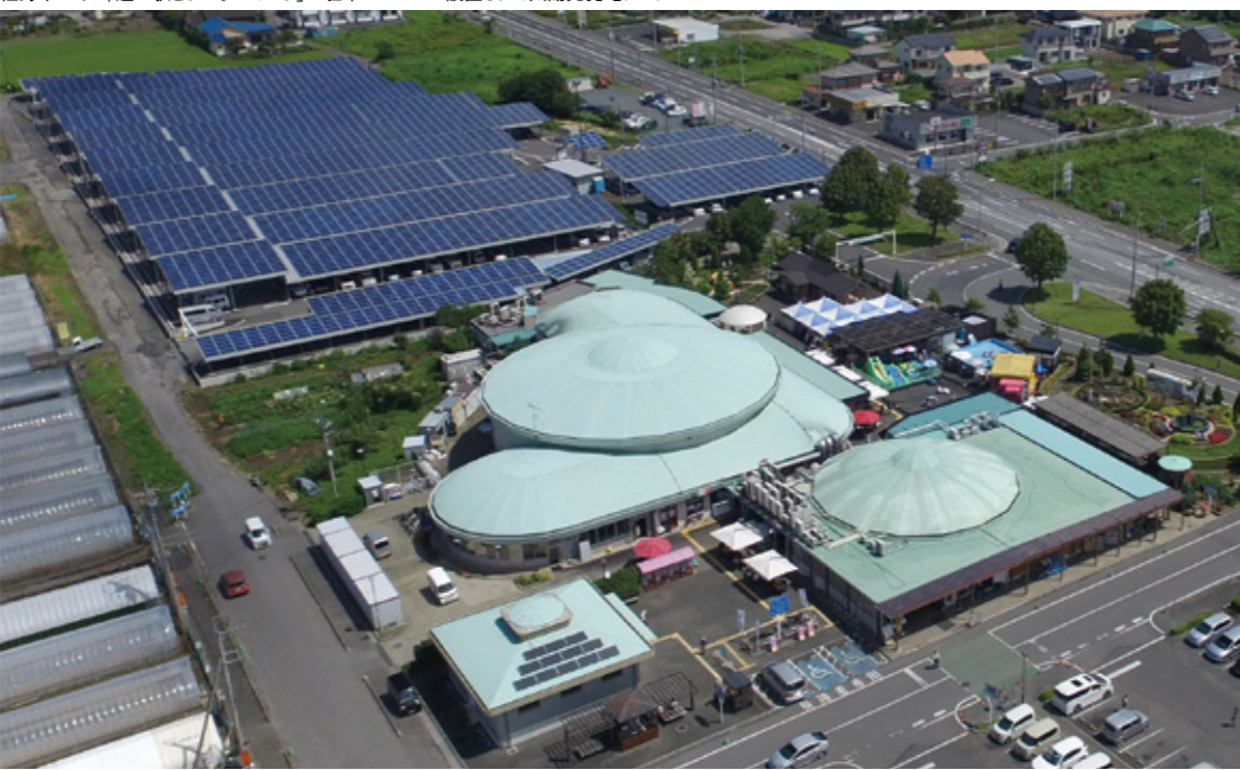
佐野市にある「道の駅どまんかたぬま」の駐車スペースに設置された太陽光発電システム
